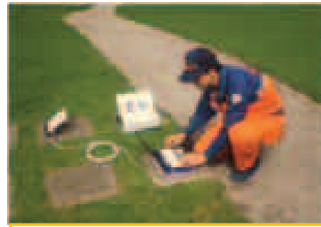
通信資機材の設置状況
