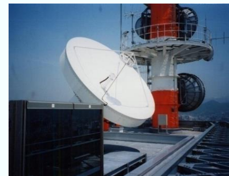
衛星固定設備
