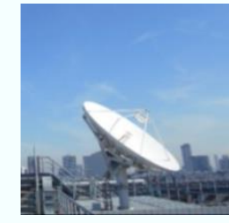
衛星固定設備
